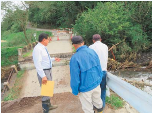
▲北杜市長坂町塚川 台風24号による逸見原橋倒壊現場(平成30年10月3日)
