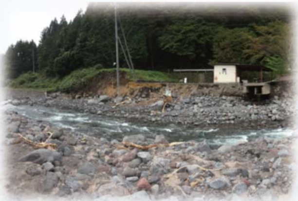
▲北杜市高根町長沢 須玉川(川俣川)護岸流失(川俣川溪流釣り場)
